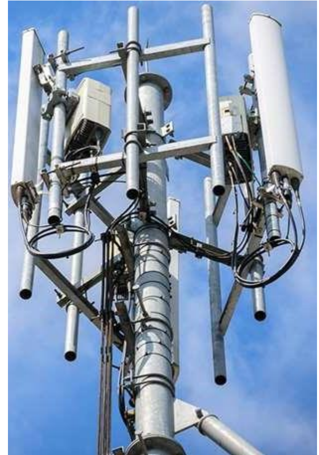
5G Antenna Array
